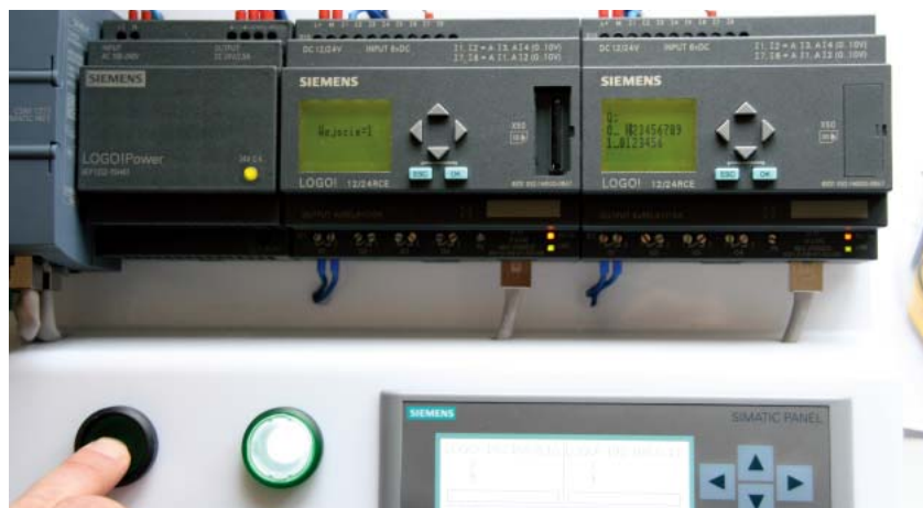
Fotografia 4. Zaświecenie lampki sterowanej za pomocą wyjścia Q1 poprzez wciśnięcie przycisku dołączonego do wejścia I1
