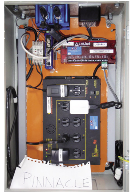
Fotografia 4. Urządzenie mierzące odchylenia i wibracje iglicy budynku Burj Khalifa zbudowane w oparciu o moduł LabJack
