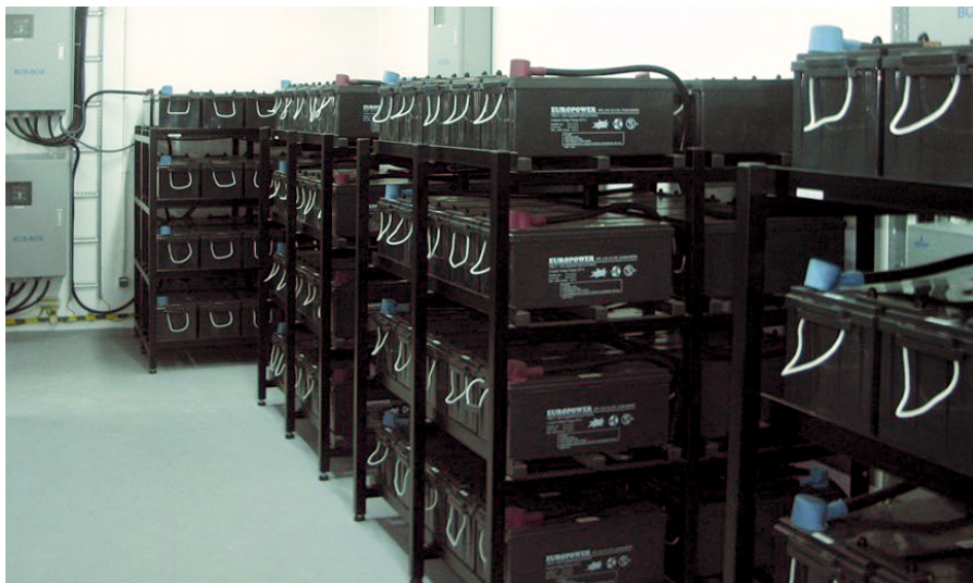
Fotografia 1. 160 sztuk akumulatorów EPL 210-12 pracujących z 4 zasilaczami UPS 200 kVA w serwerowni w Warszawie
