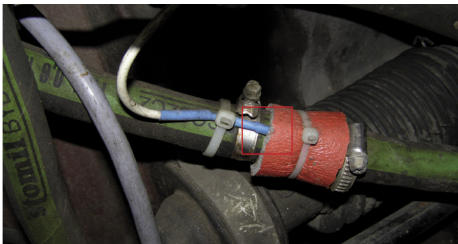
Fotografia 4. Czujnik temperatury w obiegu nagrzewnicy
