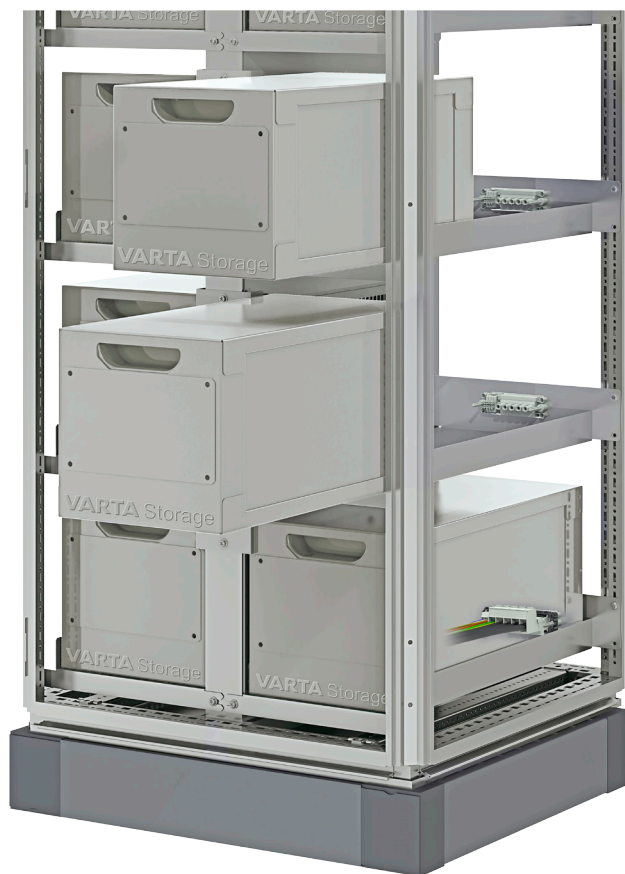
Fotografia 1. Przykład systemu typu rack – VARTA Storage. Zapewnia ekspresową wymianę pakietu akumulatorów, bez konieczności przerywania ich pracy. Połączenia wykonywane są automatycznie po dosunięciu kasyety do tylnej ściany szafy
