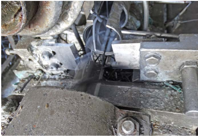
Fotografia 3. Czujnik indukcyjny zamontowany na wale
