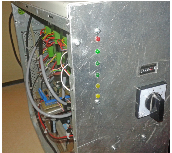
Fotografia 19. Panel szafy sterowniczej
