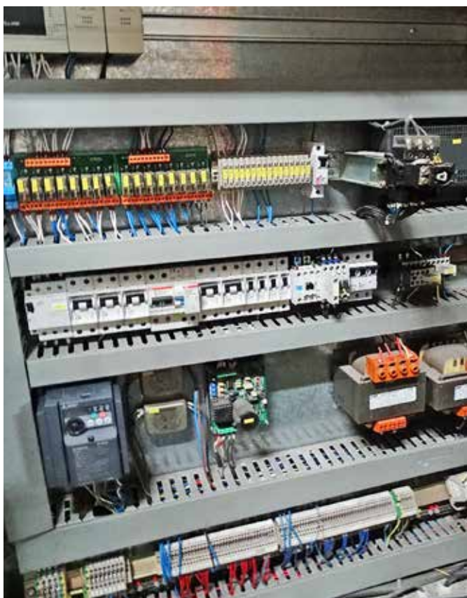
Fotografia 3. Wygląd szafy elektrycznej sterownika
