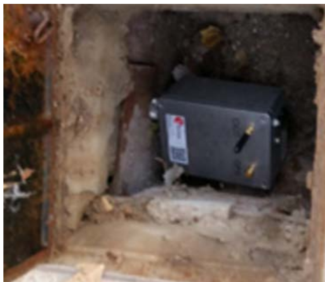
Fotografia 6. Licznik zużycia wody z modułem NB-IoT firmy u-Blox, instalacja z 2015r.
