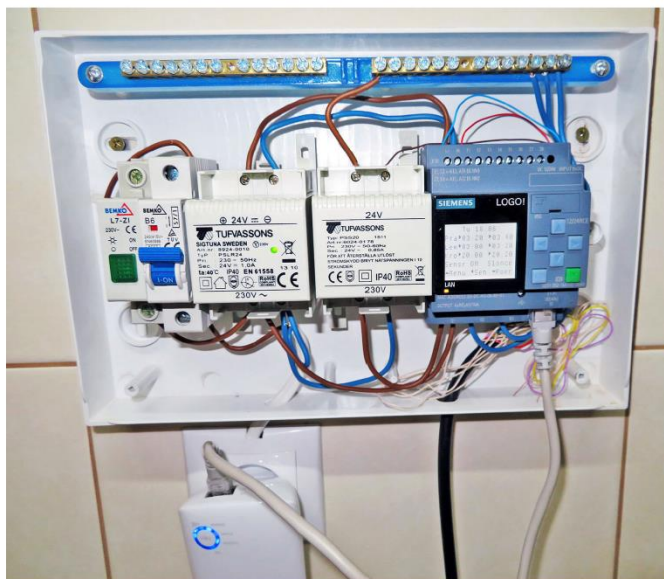
Fotografia 2. Elementy systemu sterującego umieszczone w skrzynce instalacyjnej
