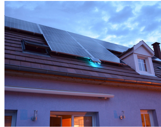
Fotografia 6. Panele zainstalowane na dachu wraz z sygnalizatorem informującym o tym, czy aktualnie wykorzystywana jest energia słoneczna czy sieciowa
