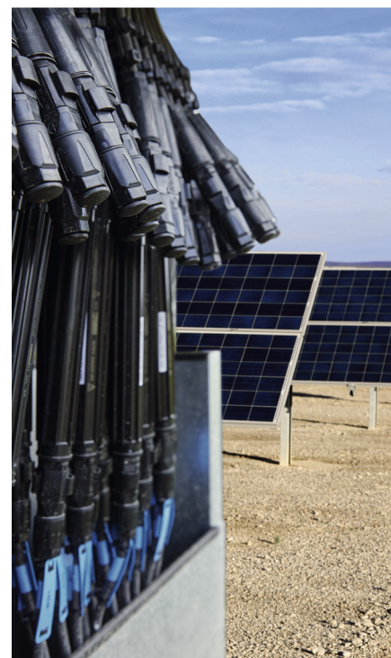
Fotografia 4. Wyprowadzenie bezpieczników DC poza szkrzynkę rozdzielczą pozwala nie tylko na zmniejszenie jej wymiarów, ale przede wszystkim na wyeliminowanie źródła ciepła z otoczenia pozostałych komponentów. Zachowanie tego samego systemu przyłączy ułatwia pracę instalatorom
