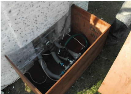
Fotografia 14. Pompka i czwórnik zabezpieczone drewnianą obudową
